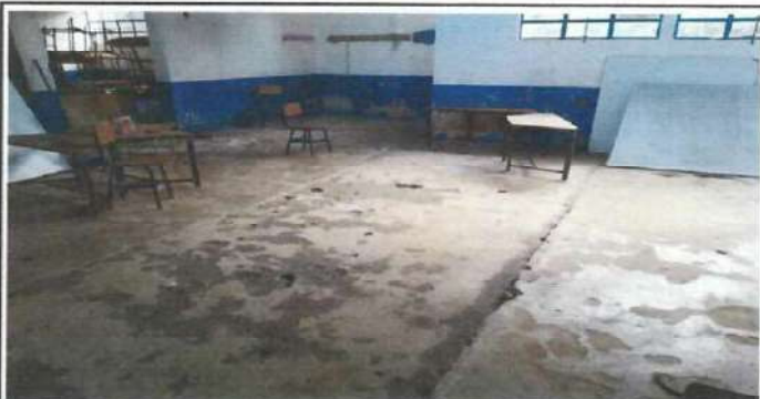
Foto 3: Piso en mal estado, necesita ser sustituido.
