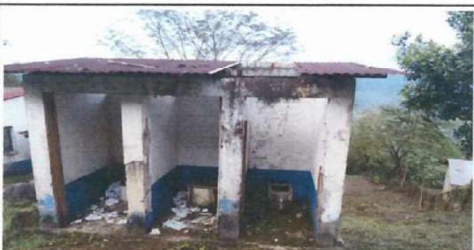
Foto 4: Baños en mal estado, necesita reparar.
