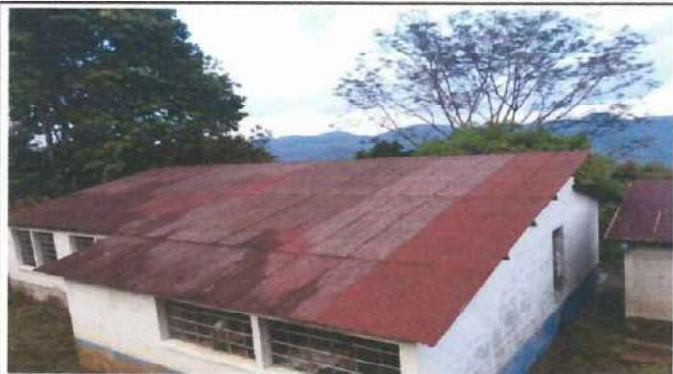
Foto 1: Se observa el techo en mal estado, necesita ser sustituido.
